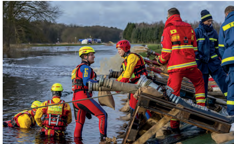
Einsatzkräfte sicherten über Tage Bereiche vor Überschwemmungen.
